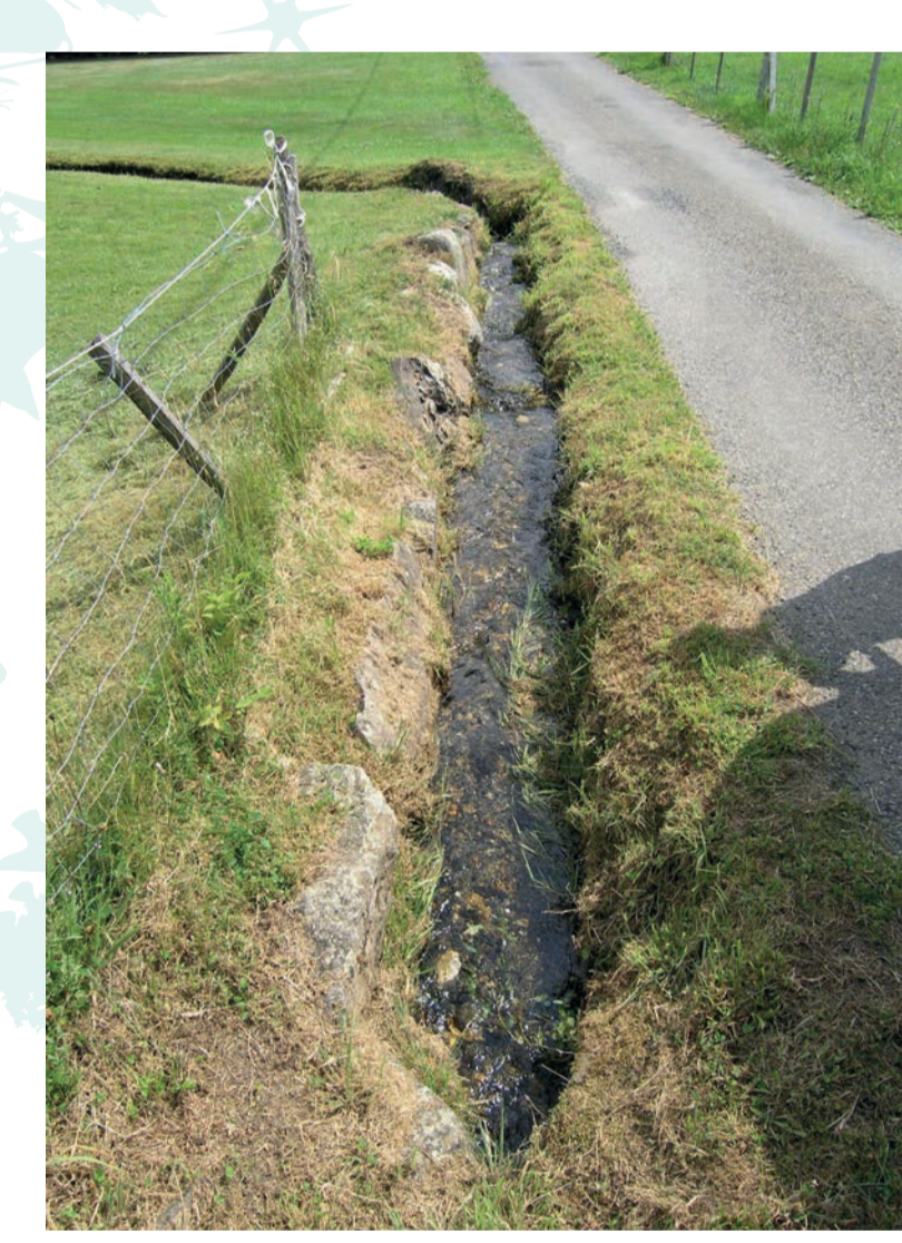
Campan (65) - rigole chemin des Bulanettes
