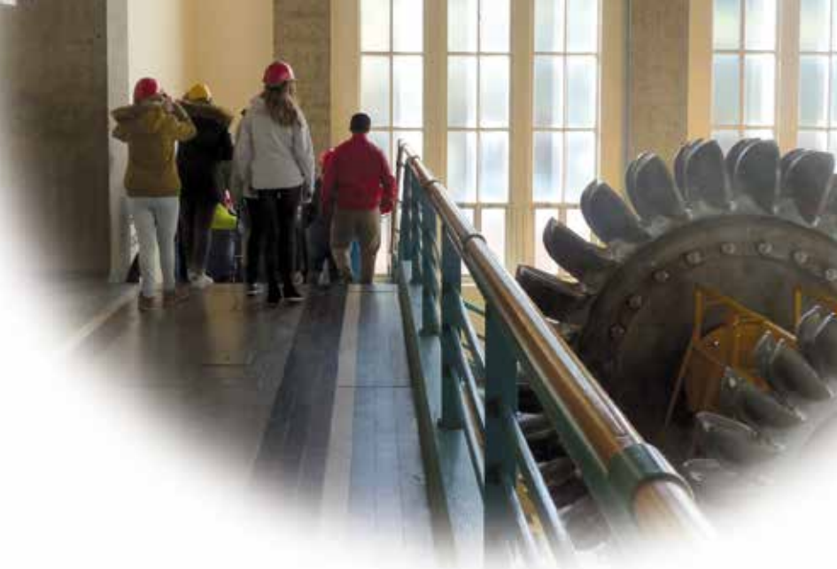
Visite de la centrale hydroélectrique de Pragnères pas les élèves du collège des Trois vallées de Luz Saint-Sauveur, vallée de Luz-Gavarnie
