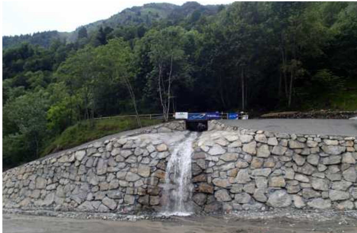
Enrochement des berges du Bastan à Barèges pour sécuriser la route en surplomb
