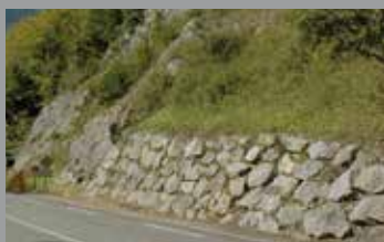
Enrochement dans la vallée d'Aspe (PNP). Même si la pierre utilisée est locale et que l'enrochement est proprement réalisé, il ne s'agit pas d'un mur de pierre sèche mais d'un ouvrage routier de soutènement.
