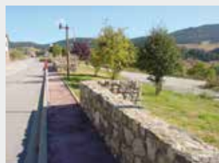
Dans cet exemple, ce muret n'est que décoratif. L'ouverture qui y a été pratiquée ne correspond à aucune fonction si ce n'est esthétique.
