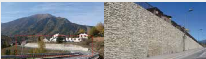
Ouvrages de soutènement en béton lisse à gauche, et en béton matricé à droite.
