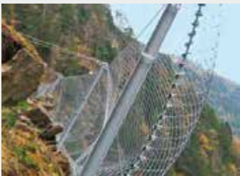
Principe de supports et de filets comme ceux installés à l'amont de Villefranche de Conflent (PNRPC).
